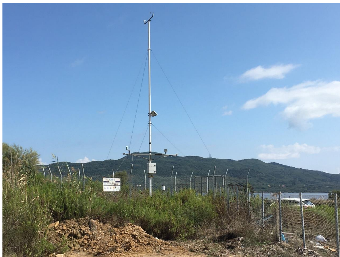
Εικόνα 2.4: Η διάταξη του σταθμού CRF-3 στην Λίμνη Κορισίων Κέρκυρας
